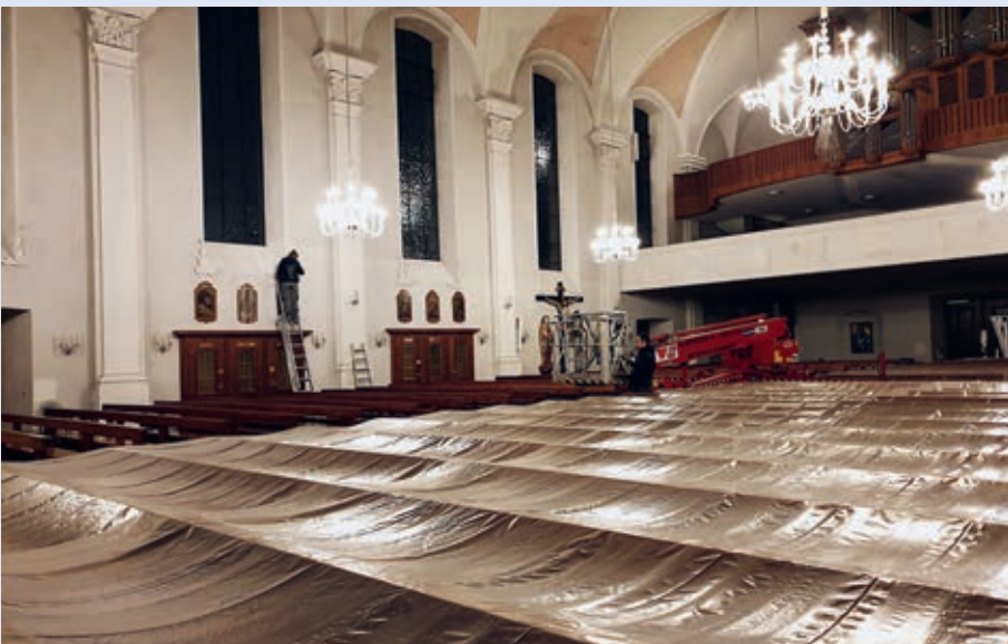
Abdeckung zum Schutz der Bänke
